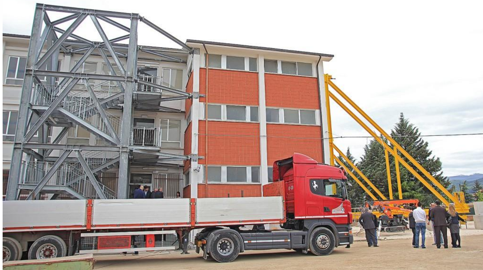
Prova sismica condotta sull'edificio del Liceo Socio-psico-pedagogico "Benedetto Croce di Avezzano" per il collaudo di un sistema di torri dissipative brevettate dall'Ing. Alessandro Balducci
