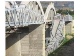
Foto 1 Campata crollata - Da notare la deformata dei correnti superiori
