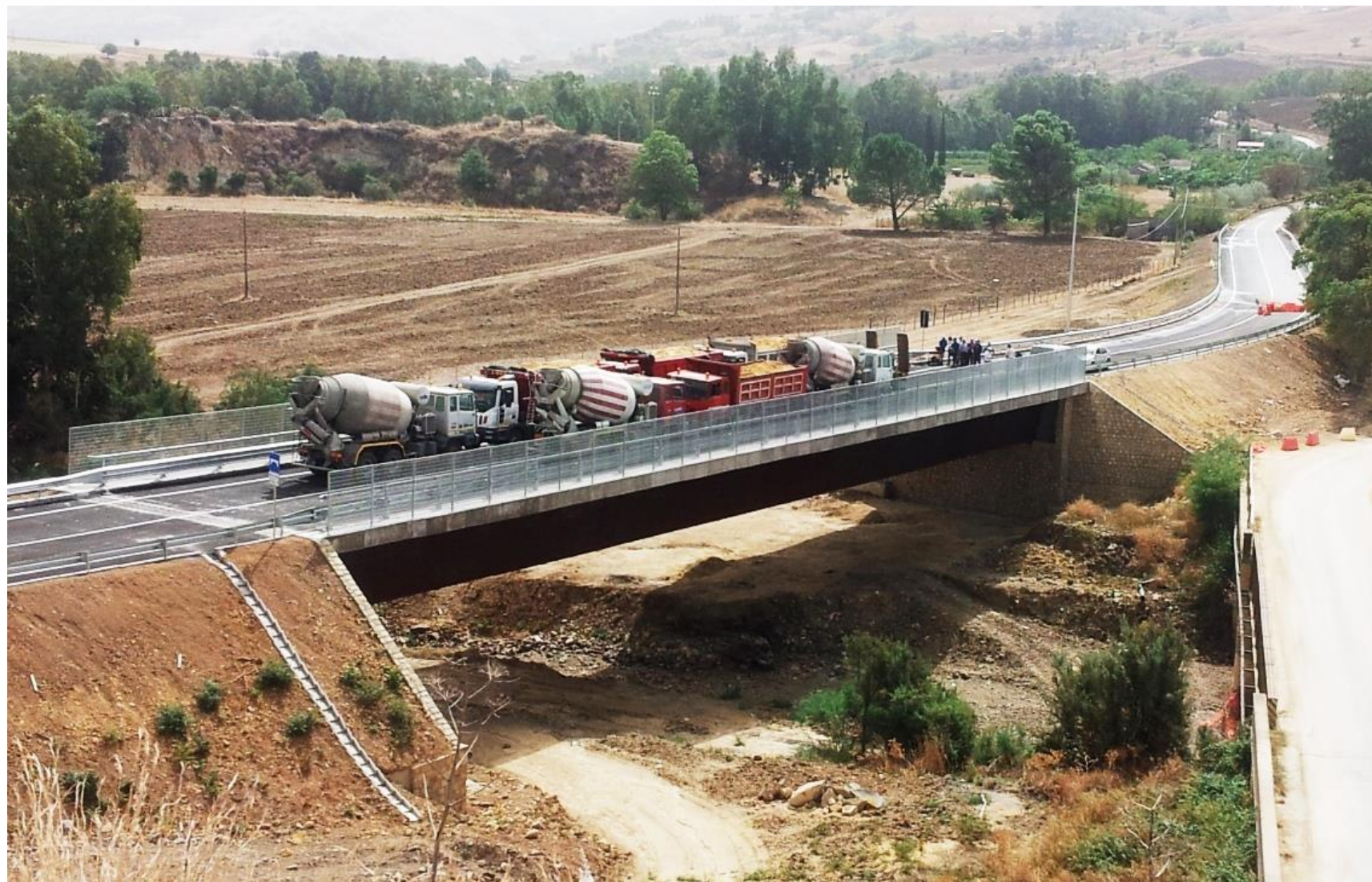
Prova di carico su ponte stradale a campata unica in acciaio – Fonte CIMENTO S.r.l.
